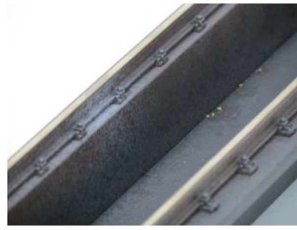
Magnus Regelspur Wartungsgrube Nr 2
